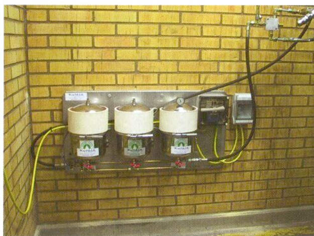
Cirkulationskrets med tre parallellkopplade filter installerad på Stora Enso i Hyltebruk för att avskilja oxidationsprodukter från tryckmediet. Denna enhet har ingen cirkulationspump utan matas från trycksidan via en tryckreduceringsventil.
